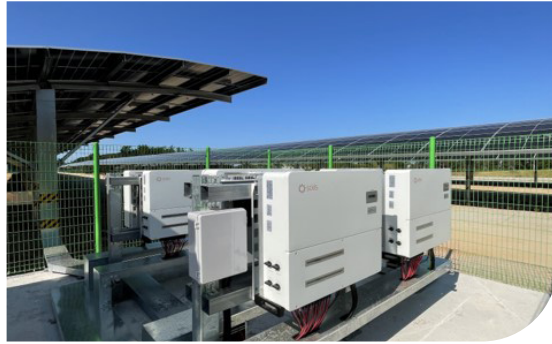
* 전라북도 고창 ( 매일유업 상하공장 RE100) 800kW
